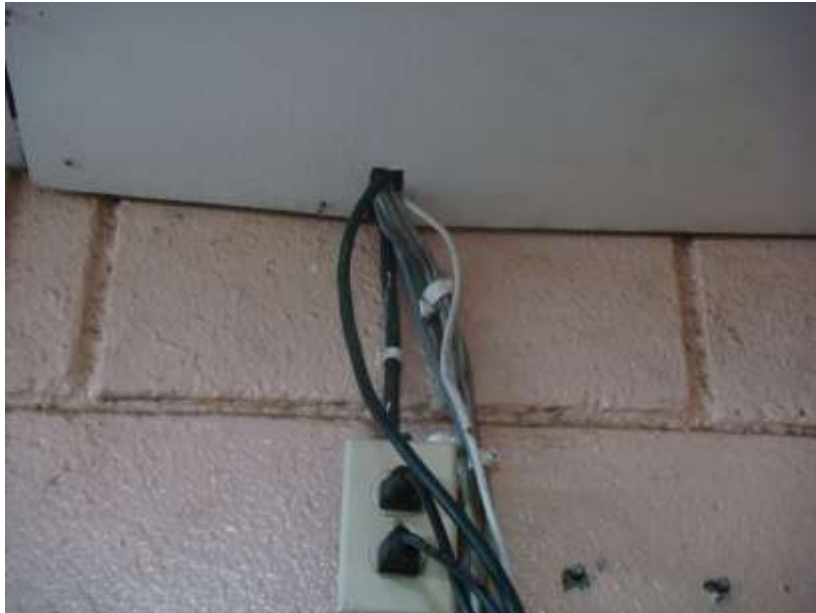
Figura 7. Parte externa del área de operaciones donde se notan las conexión de la antena hacia el router
