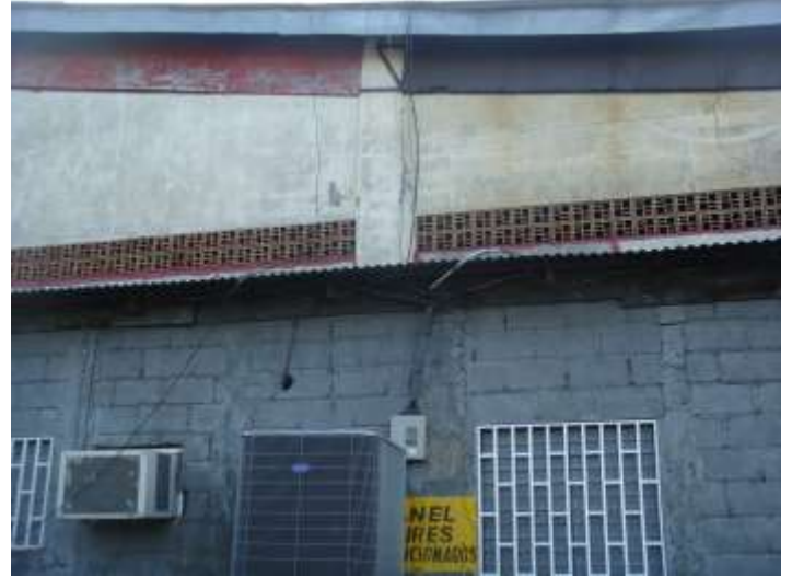
Figura 14. Conexión de antena hacia router
