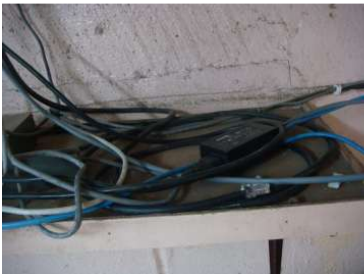
Figura 9. Cableado que sale del router a las Pc's
