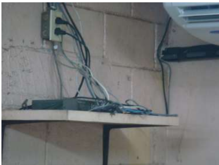
Figura 12. Vista Cercana de Router
